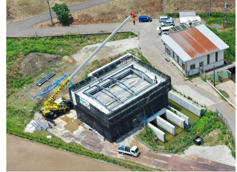
排水機場（福井市大安寺） （農村災害対策整備事業 3億5,000万円）
