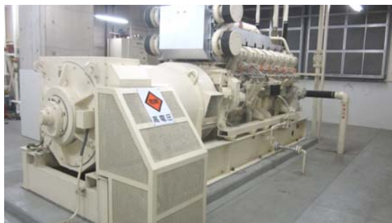
【 自家発電設備 】
