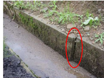
【漏水している農業用用水路】
