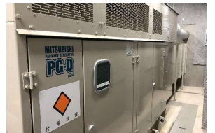
【非常用自家発電設備(イメージ)】
