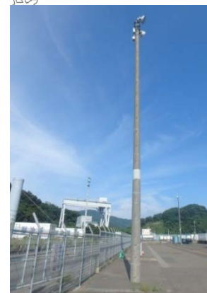
【照明設備・フェンス】 (敦賀港鞠山北地区)
