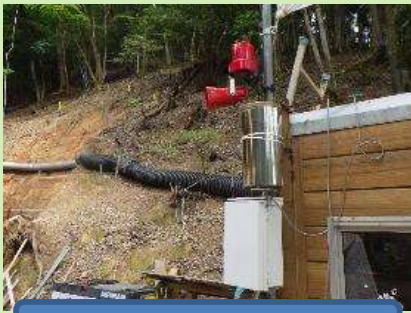
警報機付き雨量計の設置
