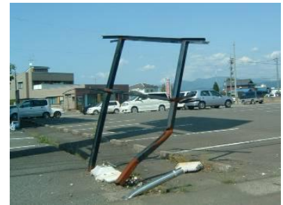
老朽化し、骨組みだけが残った広告板
