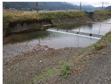
はす川に設置されている取水堰
