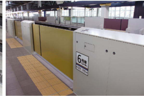
ホーム上の旅客の安全に配慮した安全柵
