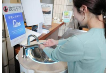
水循環型手洗設備
