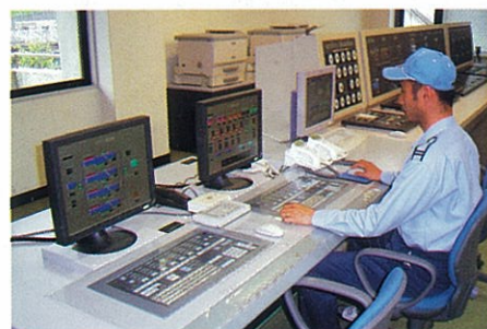
中央監視制御室
