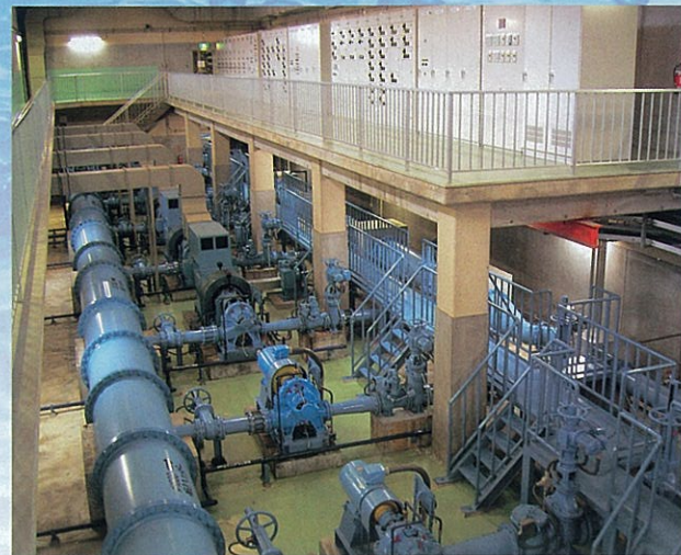
送水ポンプ設備
