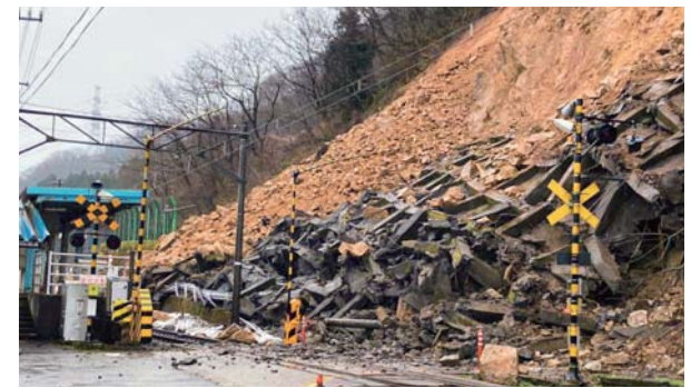
永平寺町藤巻の斜面崩壊の状況
