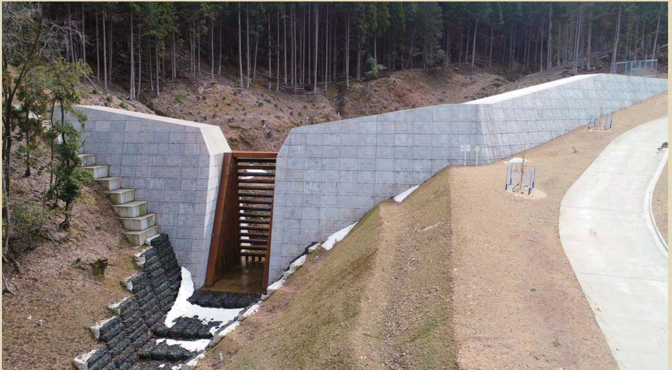
通常砂防事業〔秋夜谷川2号砂防堰堤〕（若狭町井ノ口）
