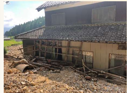
令和4年8月に発生した勝山市野向町の土砂災害
