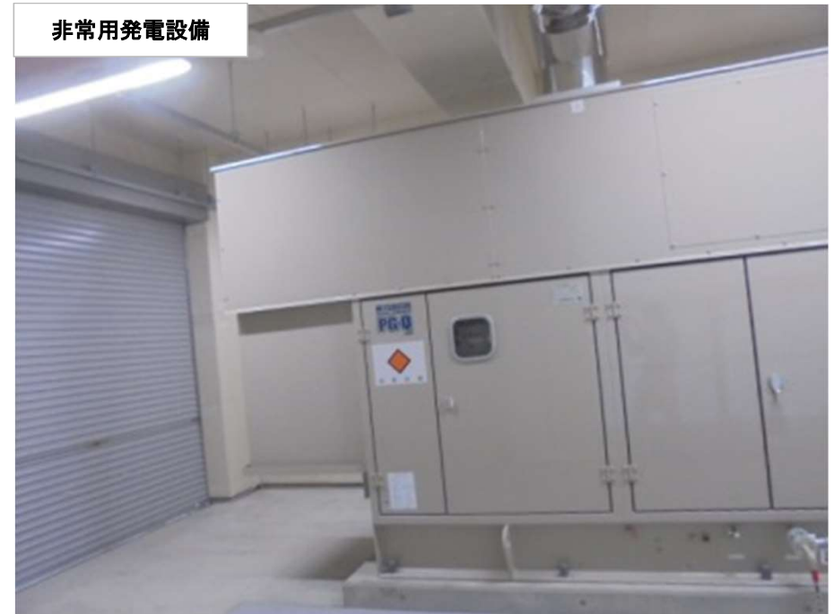
水防倉庫2階に設置した非常用発電設備
