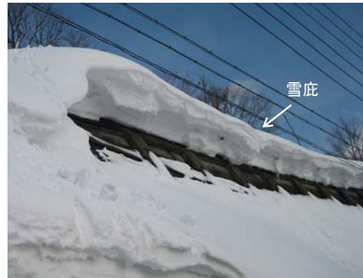
写真2 法肩にせり出した雪庇
