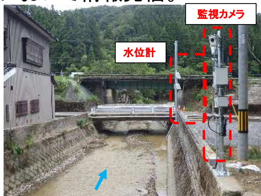
水位計、監視カメラの設置 (R5.8.31)
