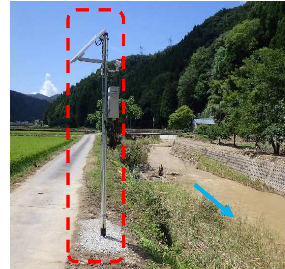
河川監視カメラ（R4.8.19設置）
