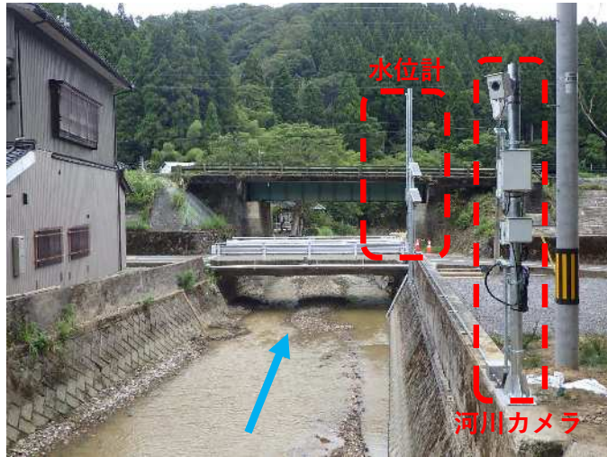
水位計・河川カメラの設置 (R5.8.31設置)
