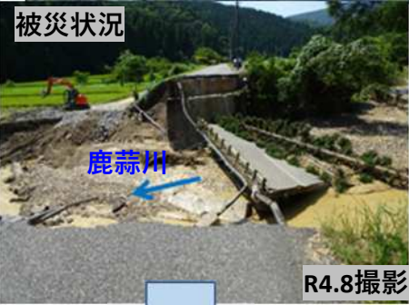
①橋梁災害箇所 4災188号（大桐1号橋）
