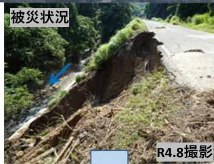
②道路災害箇所（4災179号）
