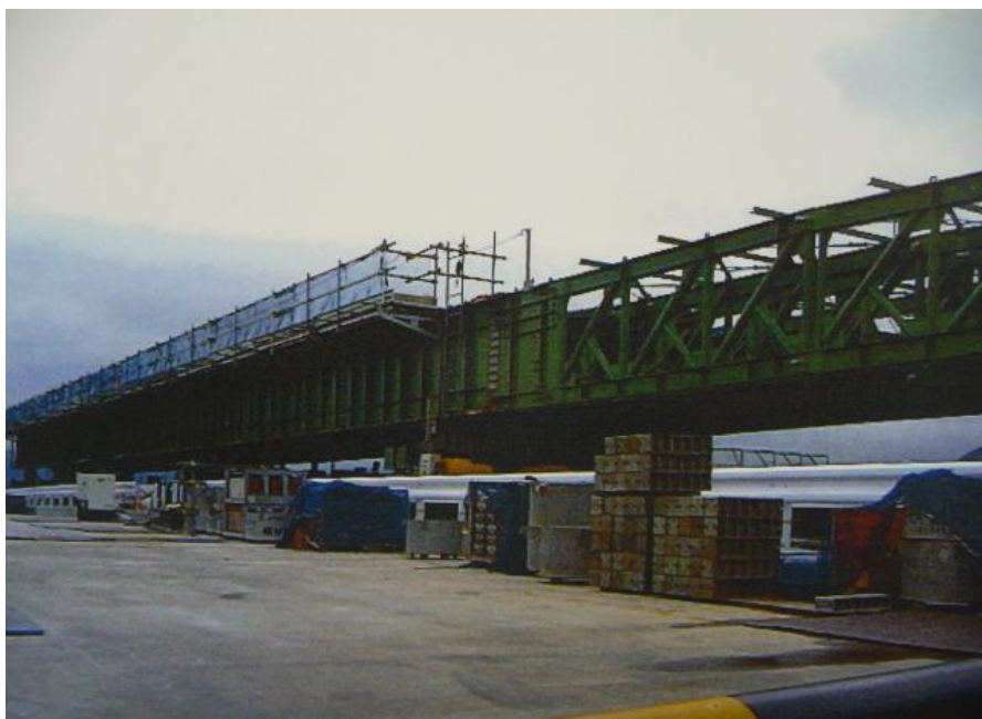
J R 北陸線を跨ぐ高架橋の橋桁設置のための鉄骨架設桁 (越前市家久町) 坪川氏が現場主任者となり、高架橋に設置する橋桁を吊り上げるための鉄骨架設桁を組み立てた。
