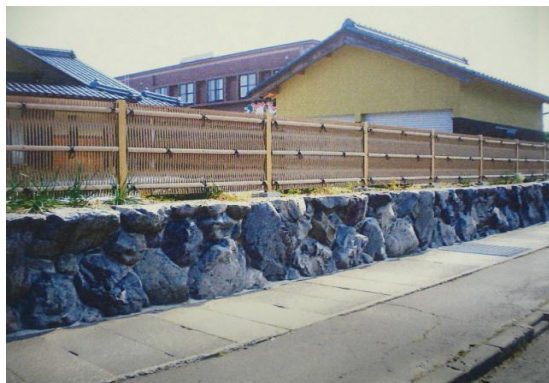
崩れ石積み (高さ1m長さ20m)
