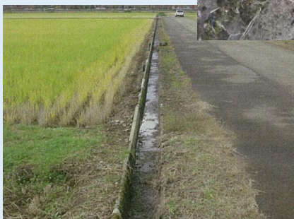
既設水路の老朽化の状況
