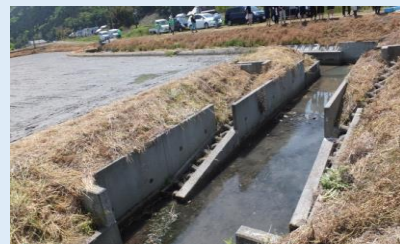
環境保全施設 (水田魚道等)
