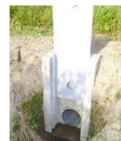
田んぼダム用「排水柵」 （小さな穴の調整版を取り付け、 水田からの水の流出を抑制）
