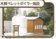
木質ペレットボイラー施設 環境にやさしい木質ペレットを燃料とする温水ボイラーで、温室の熱源に利用しています。
