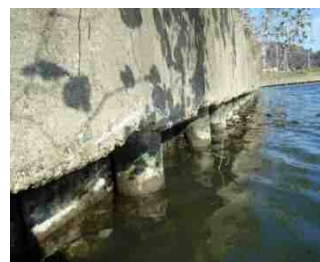
老朽化した貯木場の護岸の状況
