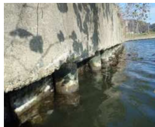
老朽化した貯木場の護岸の状況
