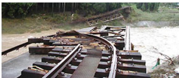
平成16年7月、福井豪雨により流失した鉄橋(第3足羽川橋梁)
