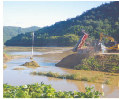
破損した堤防を強化する野木川(若狭町下野木)
