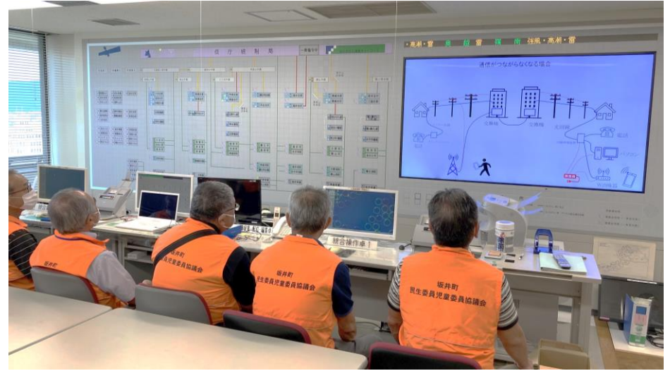
防災行政無線室
