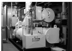
エネルギー効率の良いターボ冷凍機(イメージ)
