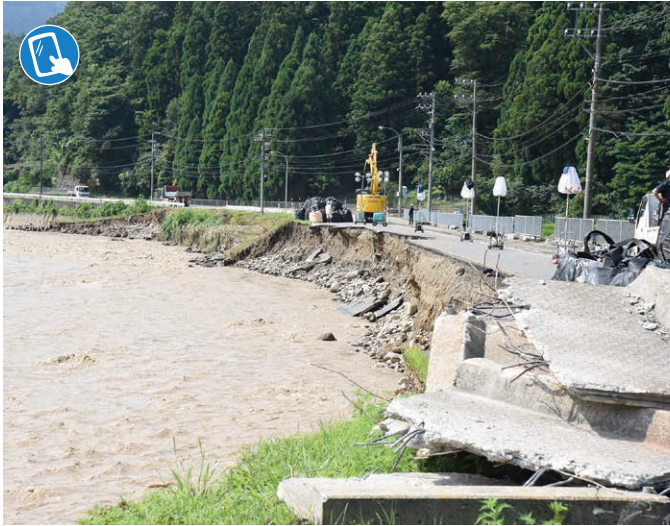
令和4年8月の大雨災害の被害状況
