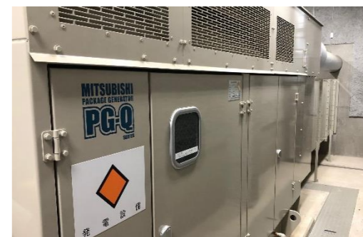
【非常用自家発電設備(イメージ)】
