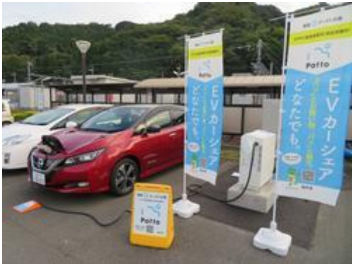
VPPと連動したEVカーシェアリング
