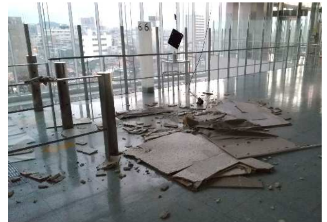
6階 天井板落下箇所
