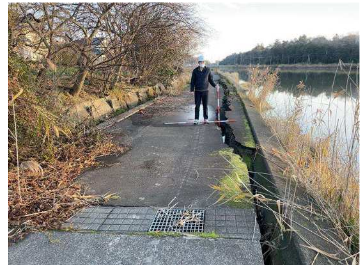
②管理用通路亀裂
