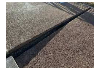
越前加賀県境の館 敷地内通路被害状況
