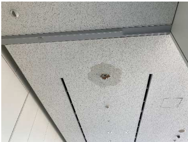
8階の出水箇所
