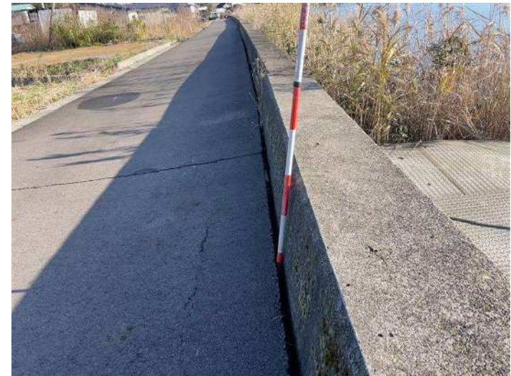
①管理用通路沈下
