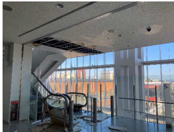
5階 天井板落下箇所
