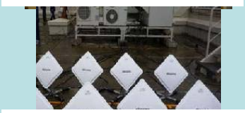
衛星電話(屋上アンテナ)
