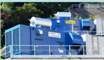
空冷式非常用発電装置
