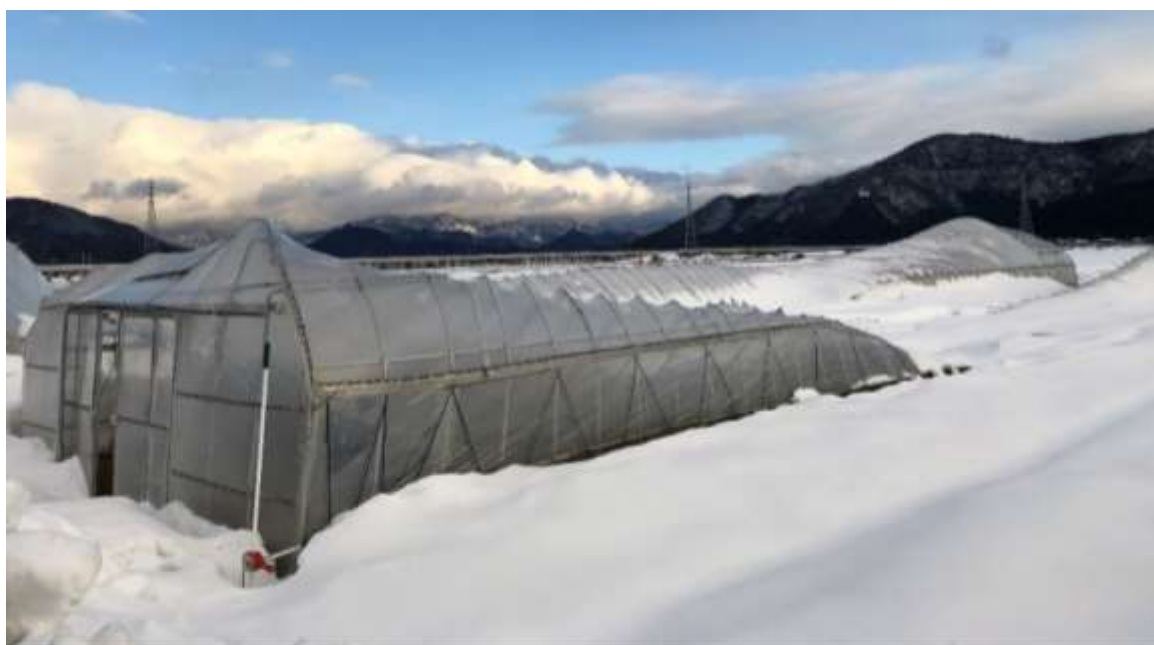
パイプハウスの被災状況（倒壊したハウス）
