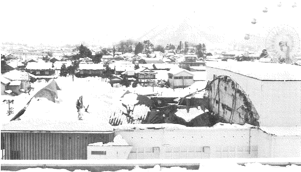
雪の重みで陥没した武生市文化センター中ホール
