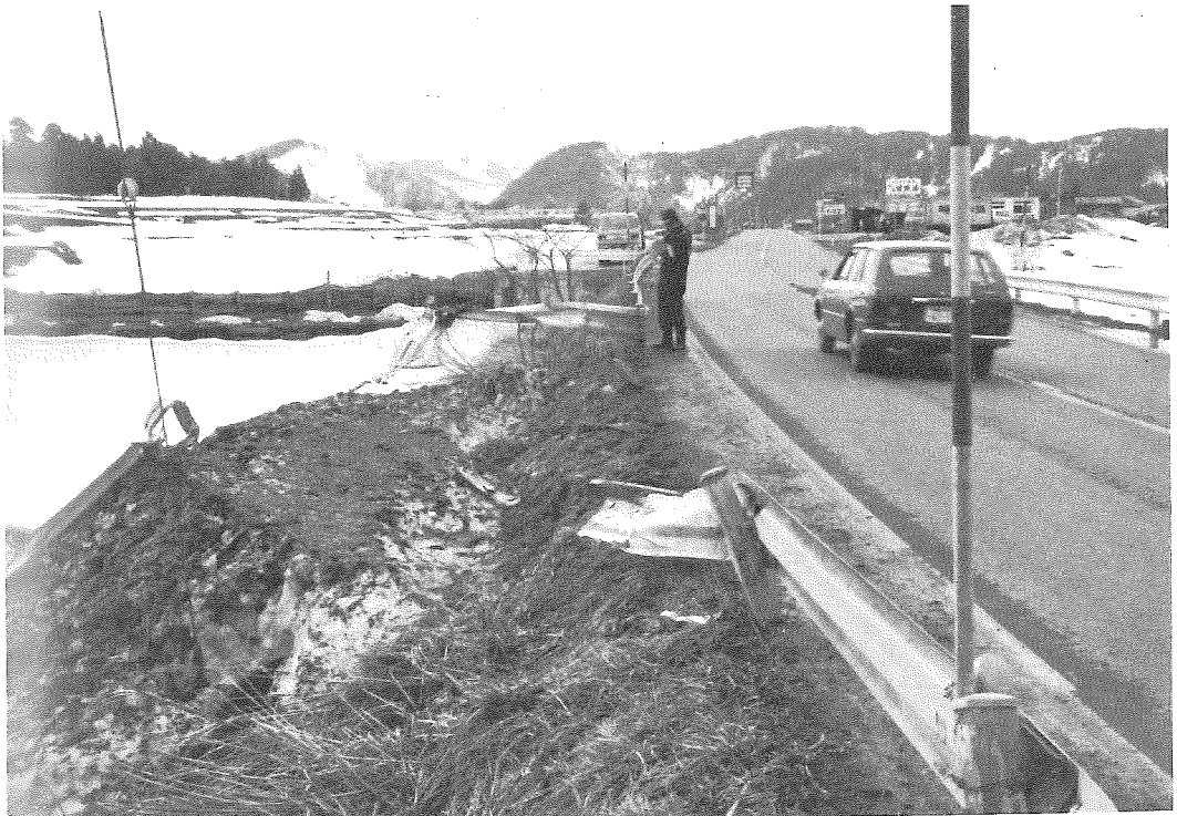
ガードレールの破損
