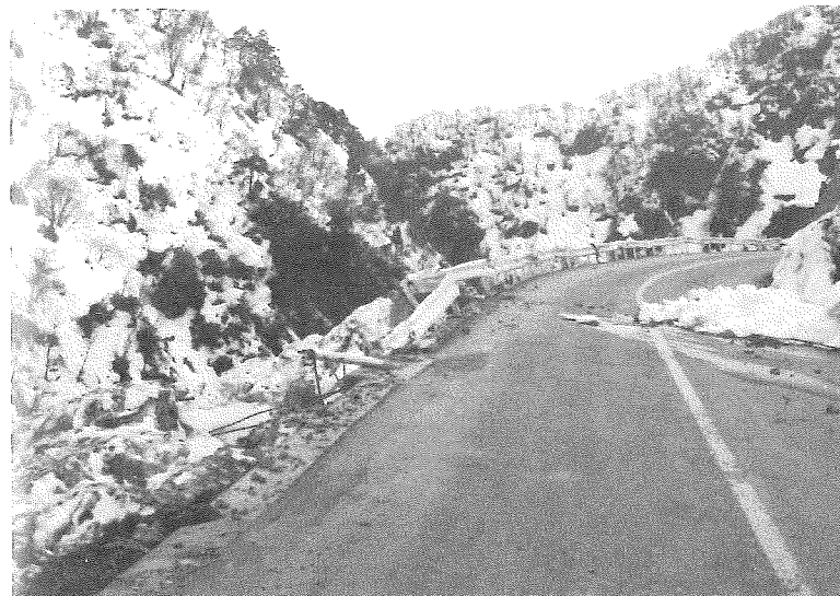
国道 158号線における交通安 全施設の崩壊
