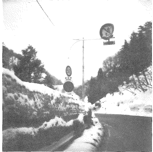
圧雪により路床が高くなり、通行車により引っかけられた大型標識板
