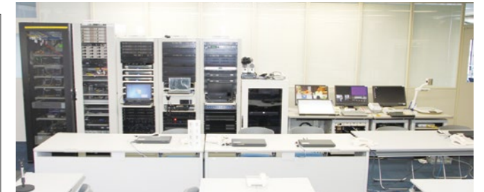
映像制御装置 (総合防災センター)
