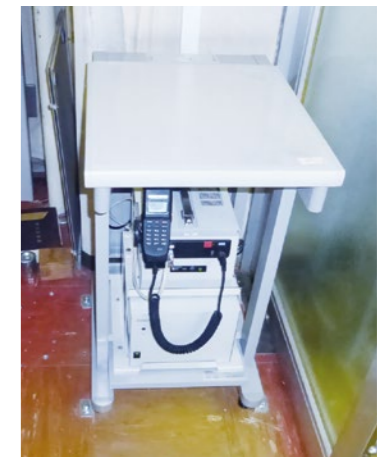
地上無線（移動系）無線装置
