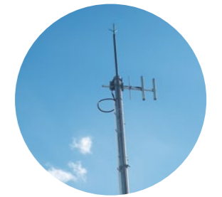
地上無線（移動系）アンテナ
