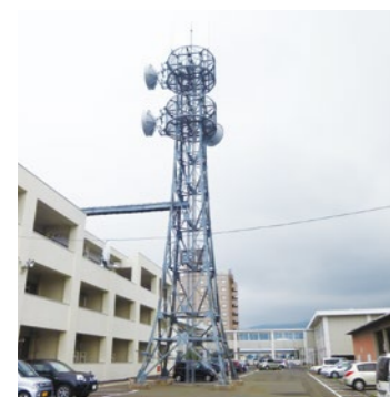
無線鉄塔（敦賀支部）
