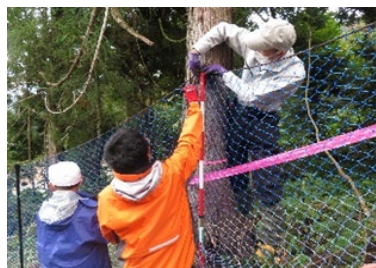
立木を支柱として活用した防護柵
