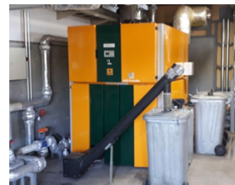
県内の木質バイオマスボイラー
