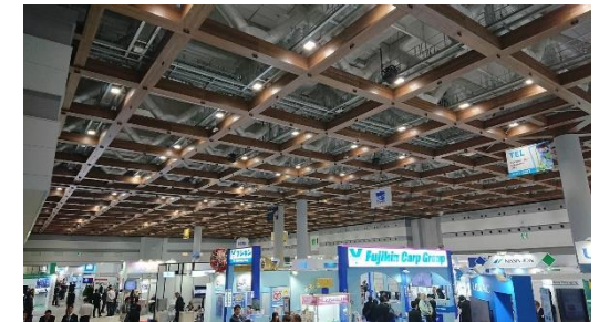
都市圏における需要拡大の事例 (東京ビッグサイト南展示棟の化粧材)
