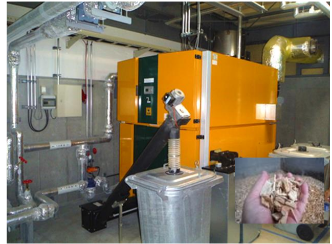
木質バイオマスボイラー
