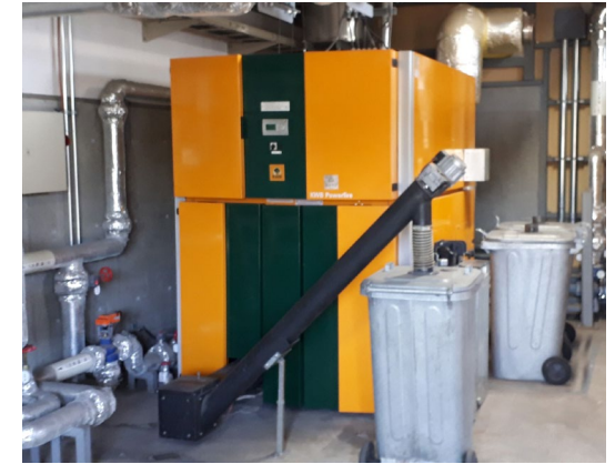
温泉施設ボイラー (あわら市)
