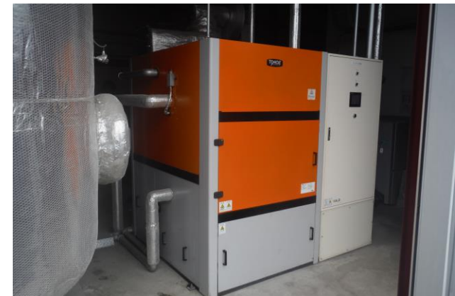
温泉施設ボイラー (あわら市)
