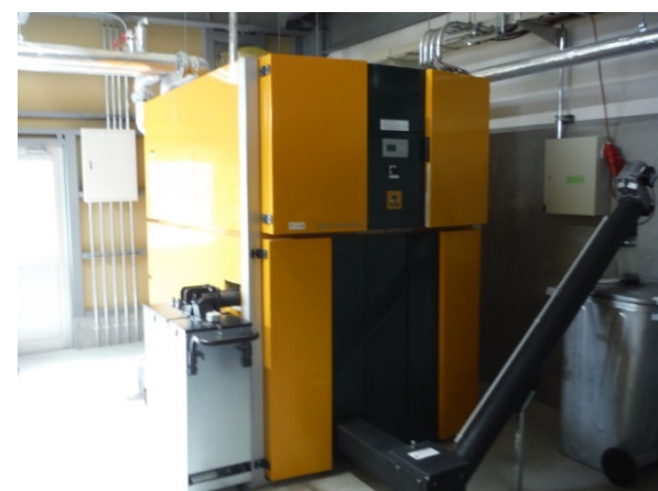
木質バイオマスボイラー (あわら市)
