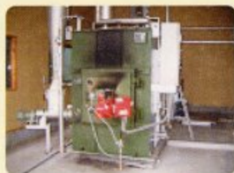
木くず焚きボイラー
