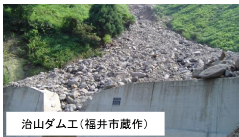
治山事業(治山ダム工)による流出土砂の捕捉事例
