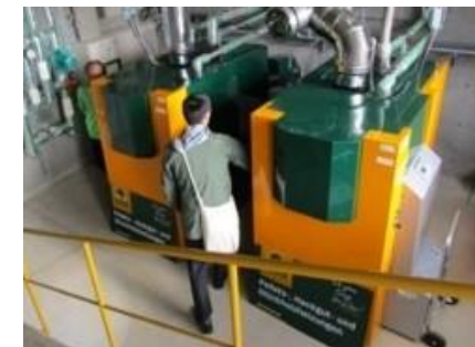
木質バイオマスボイラー
