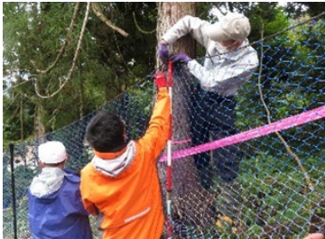
立木を支柱として活用した防護柵
