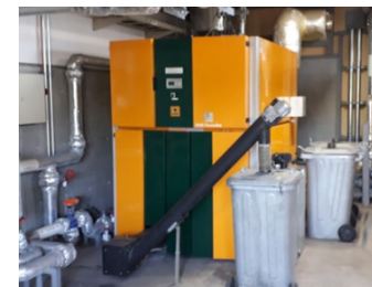
県内の木質バイオマスボイラー
