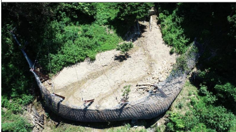
【治山ダム工【リングネット】（福井市蒲生）】
