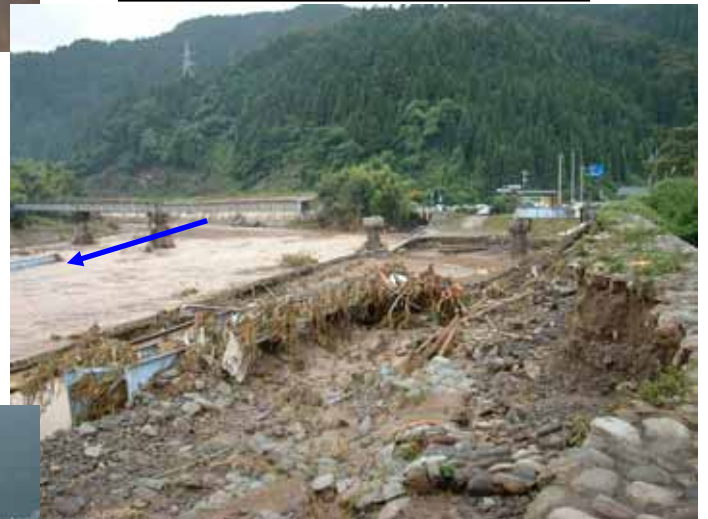
写真 - 落橋した越美北線橋梁と被災した堤防の状況
