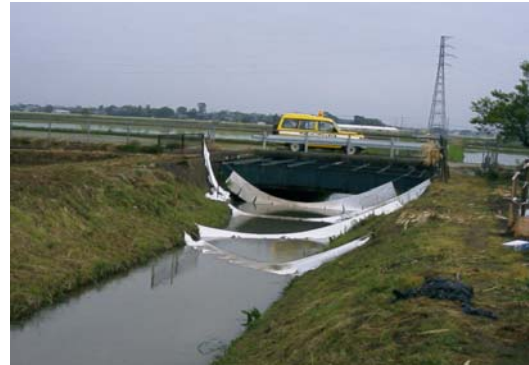
田島川 油流出事故処理 (坂井市坂井町御油田)
