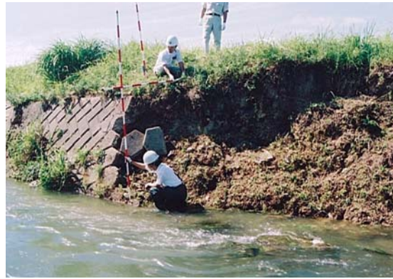
兵庫川 護岸被災（坂井市坂井町若宮）
