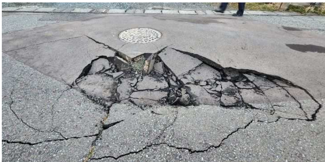
下水道施設の被害【あわら市】
