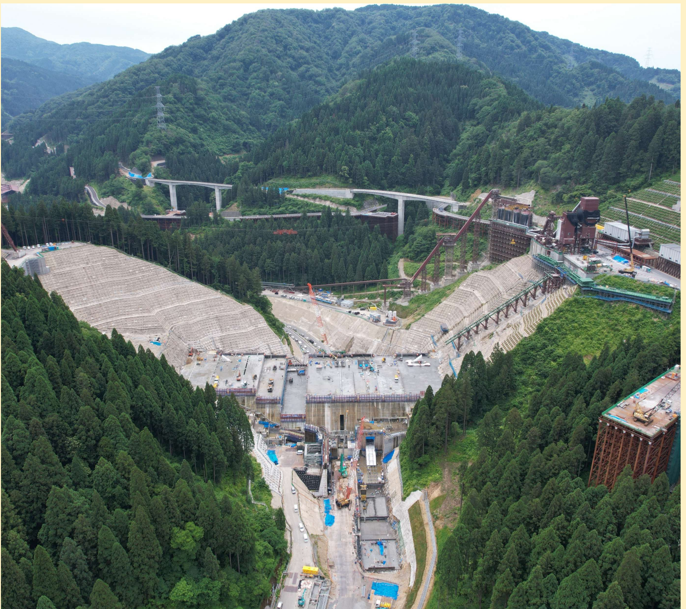
足羽川ダム建設現場（池田町） 洪水被害の軽減を目的とした日本最大規模の流水型ダム
