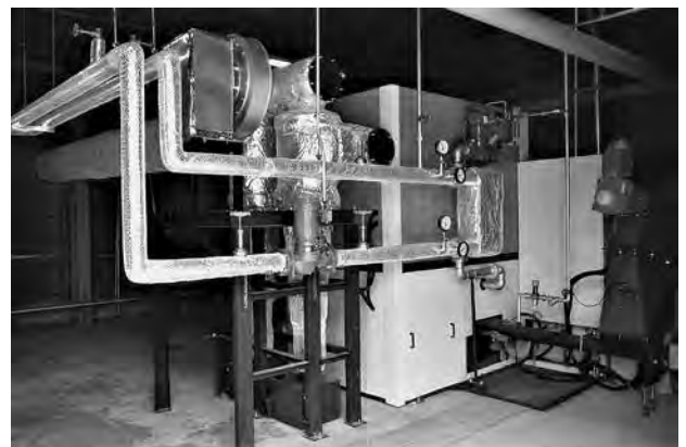
温泉施設に設置された 木質チップボイラー（あわら市）
